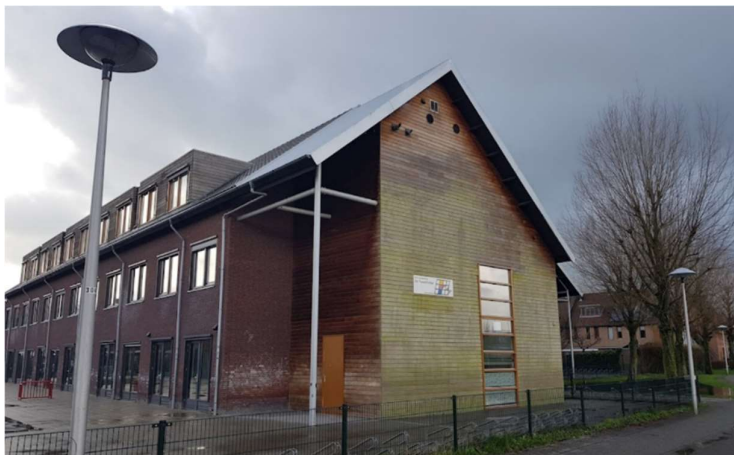
Voorbeeld van verkleuring/vervuiling houten gevel
